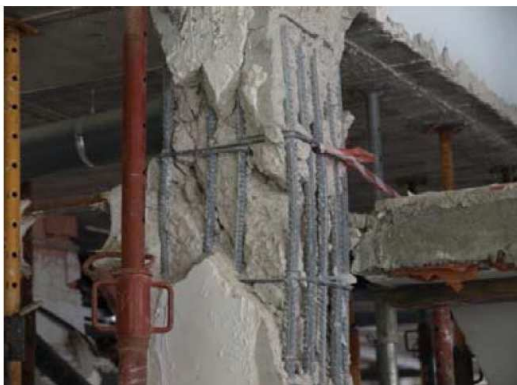
FIGURA A 3. Daño severo en pilar de hormigón armado.
